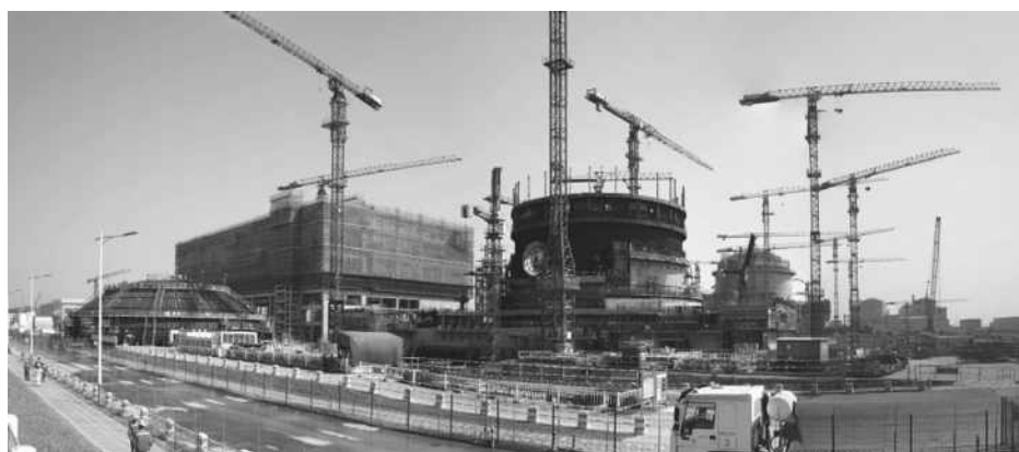
建設中の華龍1号プラント、防城港原子力発電所3、4号機(広西壮族自治区防城港市、19年11月8日筆者撮影)
