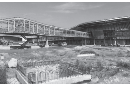
建設中の北京新空港 ※中国当局は9月14日、名称を「北京大興国際空港」とすること、工事が順調に進行していることを発表した。
