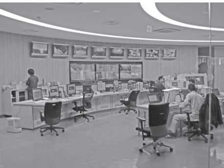
京都市北部クリーンセンターの中央管理室
